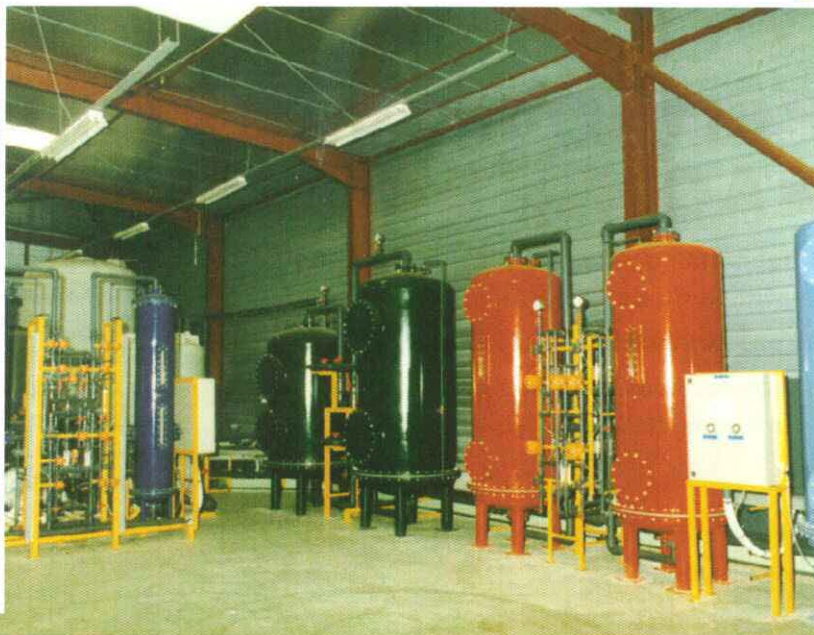
Ⓢ Chaîne de déminéralisation.
