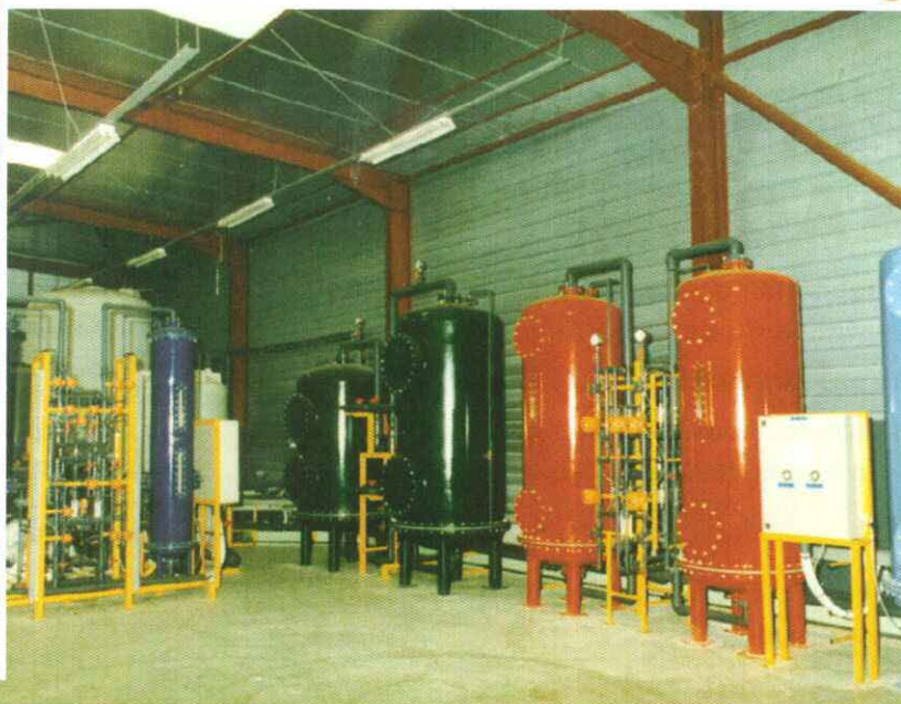
Ch Chaîne de déminéralisation.
